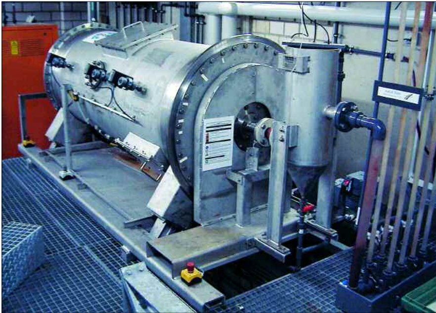
Roto-Bio-Reaktor (RBR) aus meerwasserresistentem Stahl im Delphinarium Duisburg, mit einer Leistung von 3 m 3 /h. Das System wird mit Ethanol betrieben ( www.aquacare.de ) Foto: B. Sellner und B. Ramsch
