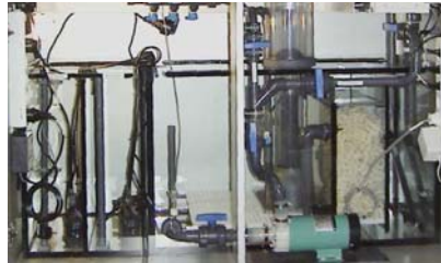
Filterbecken, Nachfüll- und Mischbecken aus Glas für ein Meerwasseraquarium. Foto: AquaCare
