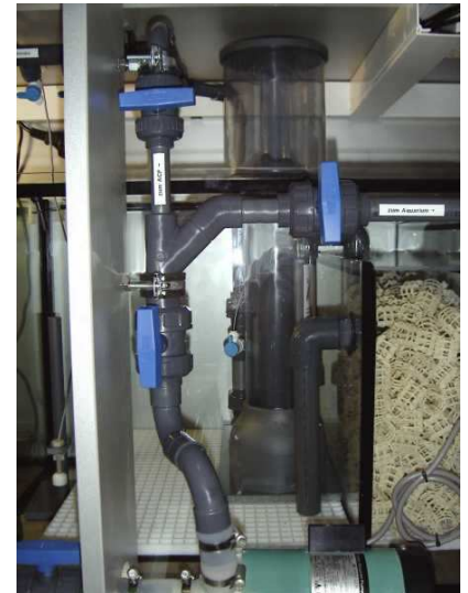
Eine ordentliche und stabile Verrohrung aus PVC ist Voraussetzung für einen sicheren Betrieb ohne Überschwemmungen.
